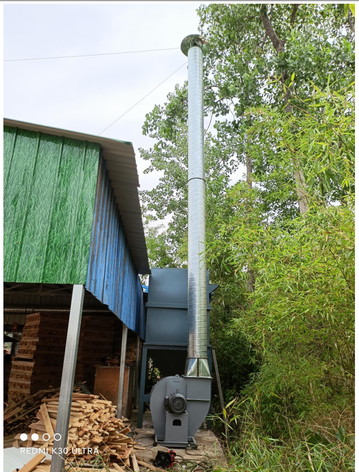
图 2-5 废气处理设施及 15 米高排气筒 FQ1
