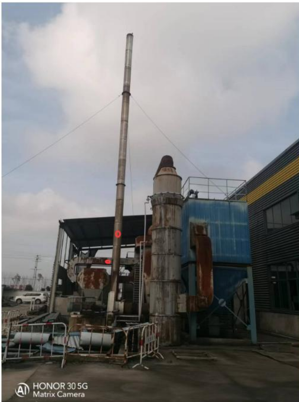
1#车间生物质燃烧废气处理设施 DA003 排气筒
