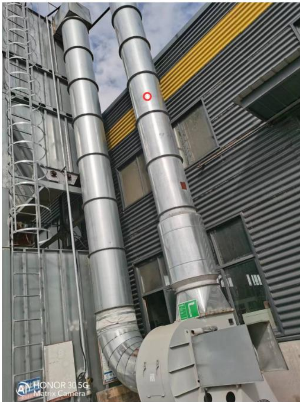
1#车间锯边、砂光废气处理设施 DA001 排气筒
