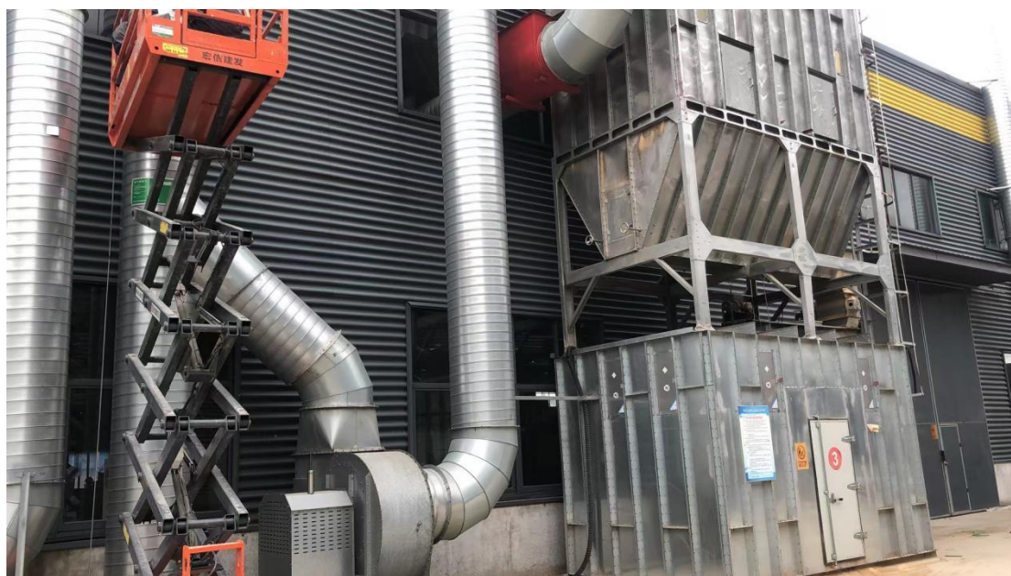
2#车间拉丝、砂光废气处理设施 DA006 排气筒
