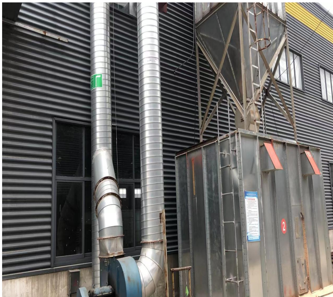
2#车间分片、砂光废气处理设施 DA008 排气筒
