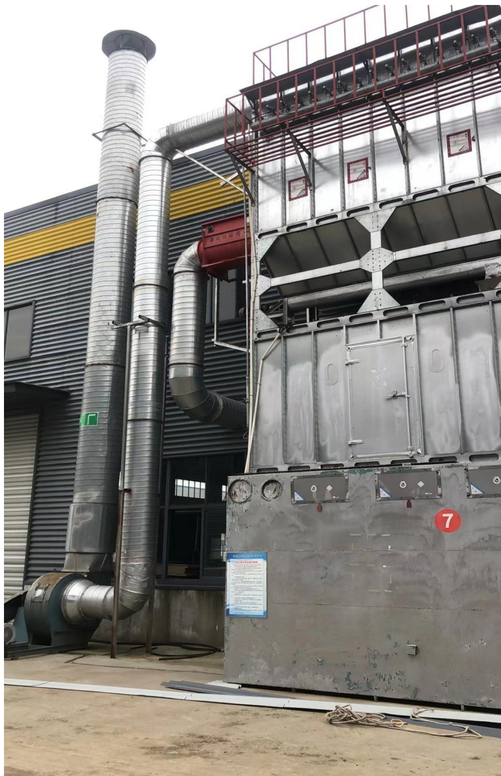
3#车间砂光废气处理设施 DA010 排气筒
