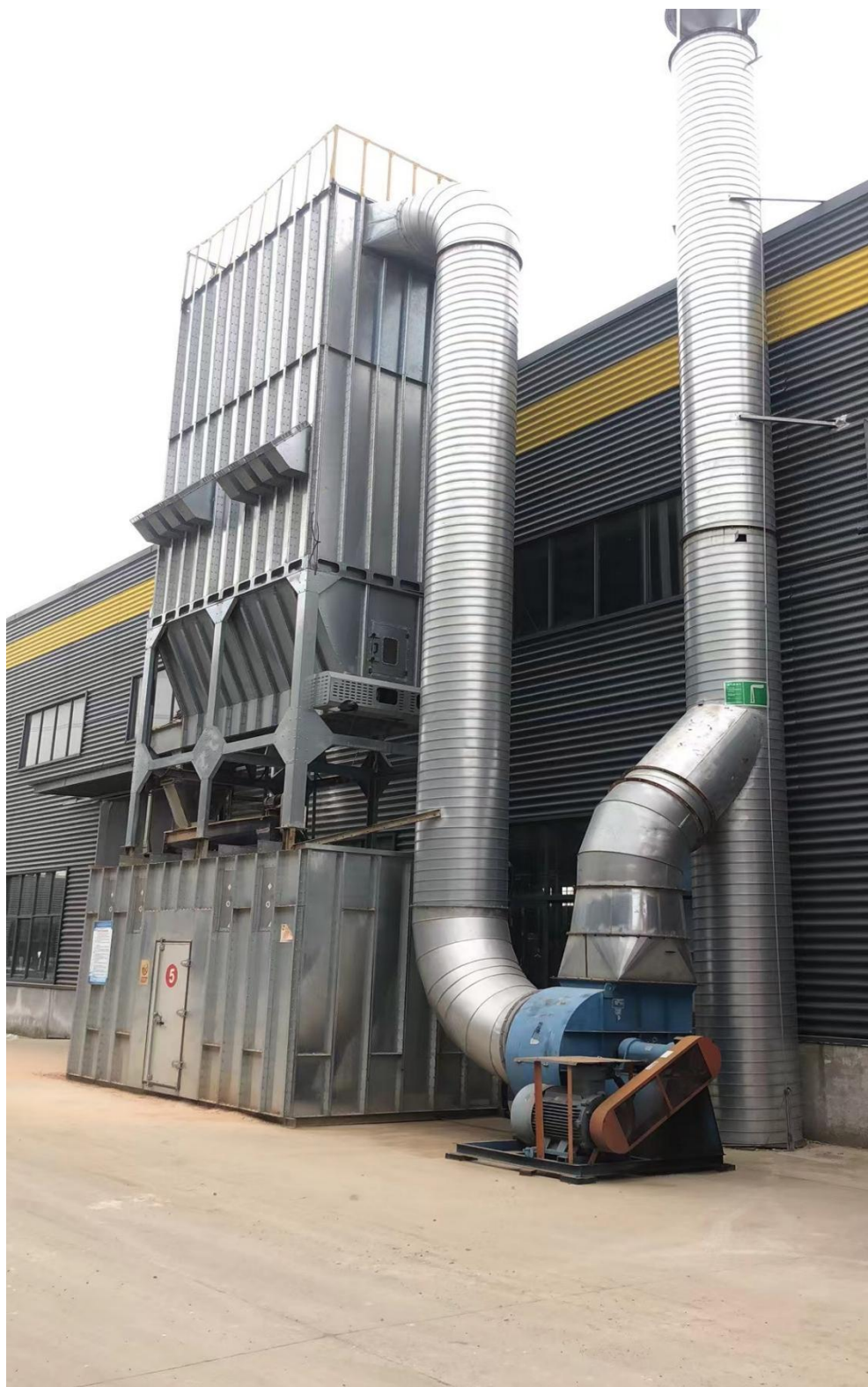
2#车间成型加工废气处理设施 DA004 排气筒
