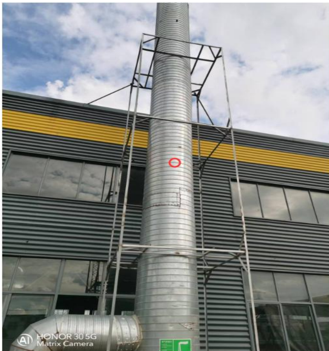
1#车间涂胶、冷压、热压废气处理设施 DA002 排气筒
