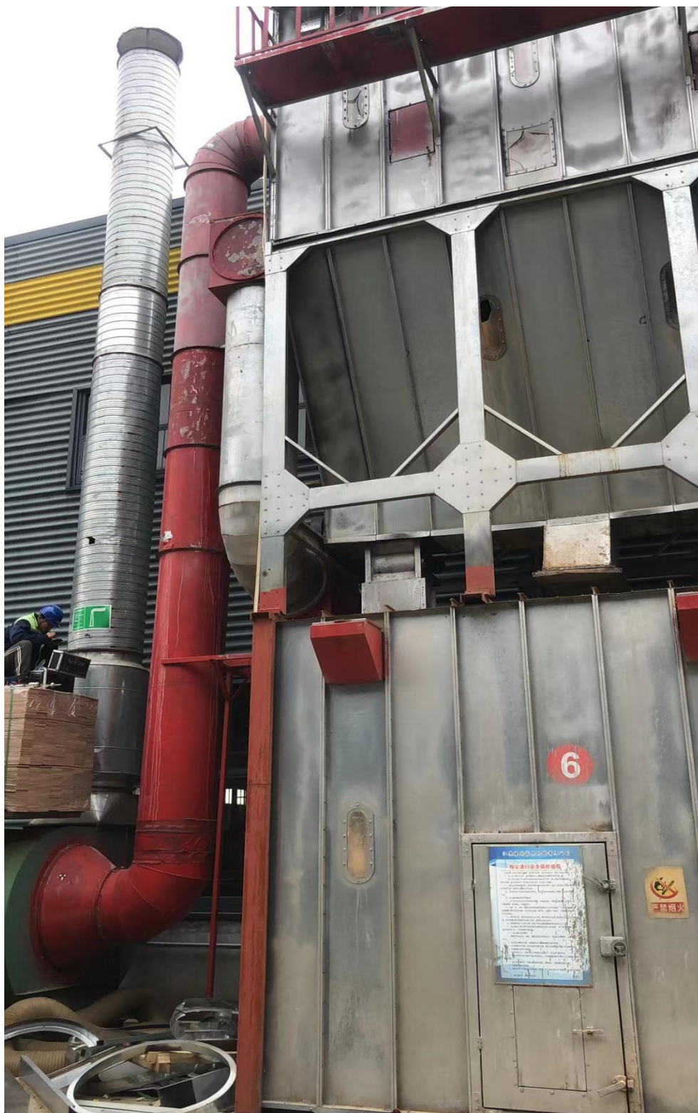
3#车间锯切废气处理设施 DA009 排气筒
