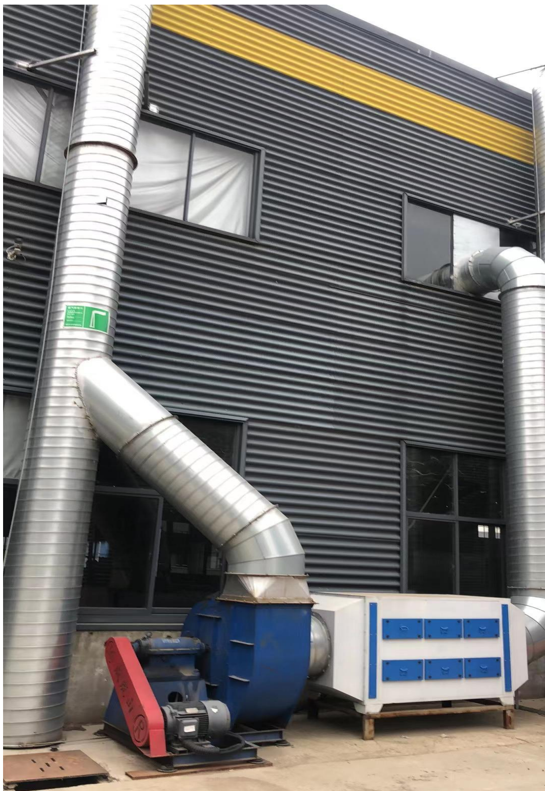
2#车间淋漆、固化废气处理设施 DA007 排气筒
