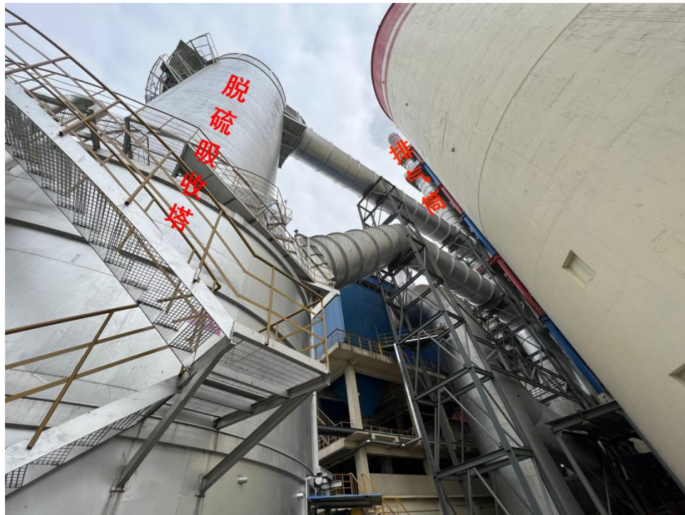
脱硫吸收塔废气处理、排放装置
