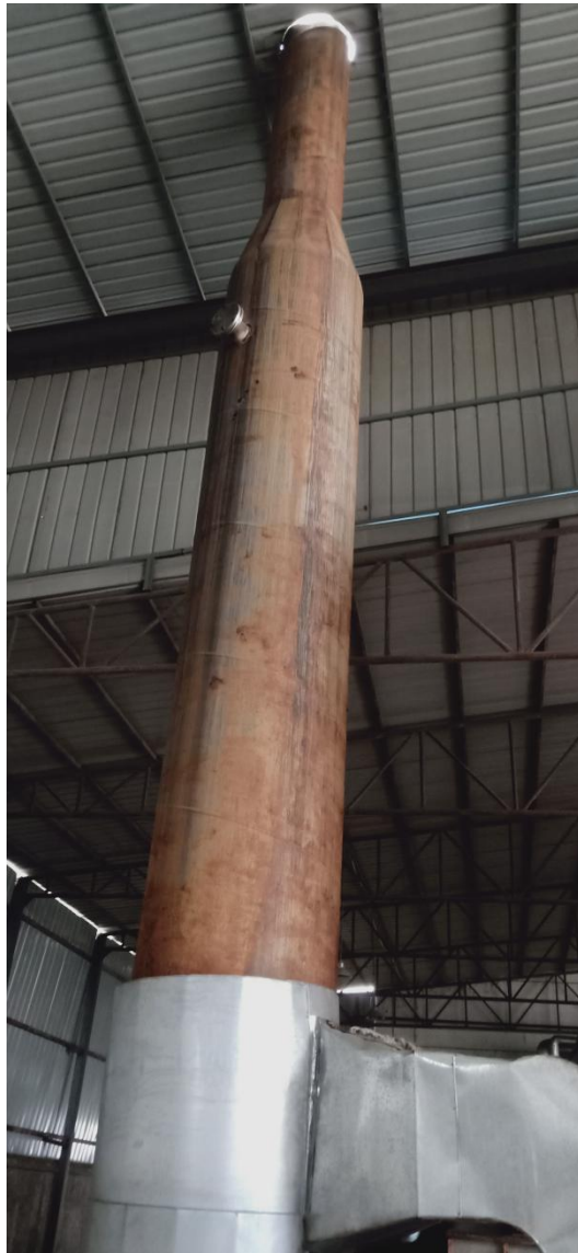
天然气燃烧废气 15 米高排气筒
