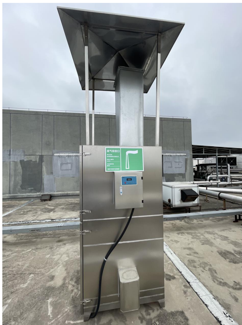
废气排放口标识
