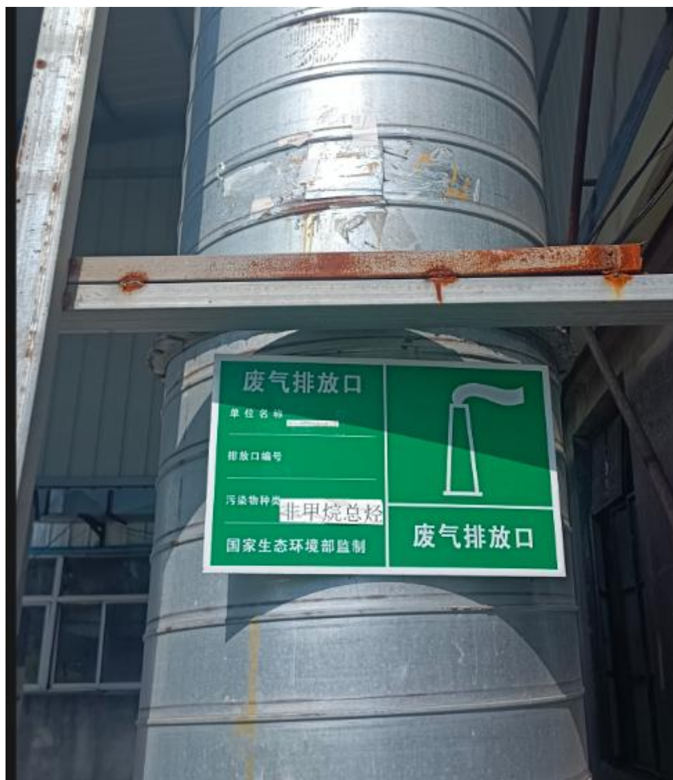
废气处理设施及排气筒图片
